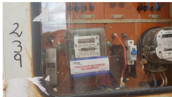
FOTO 3. Medidor con corte de servicio por falta de pago de tres meses
