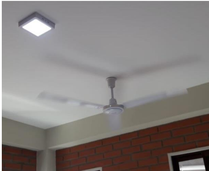
FOTO 6 Instalaciones en viviendas
